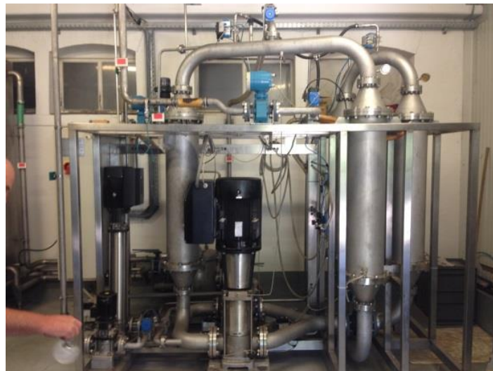
Fig. 6: The four stainless steel modules of the nanofiltration plant provided by Andreas Junghans – Anlagenbau und Edelstahlbearbeitung GmbH & Co. KG in Frankenberg/Sachsen
